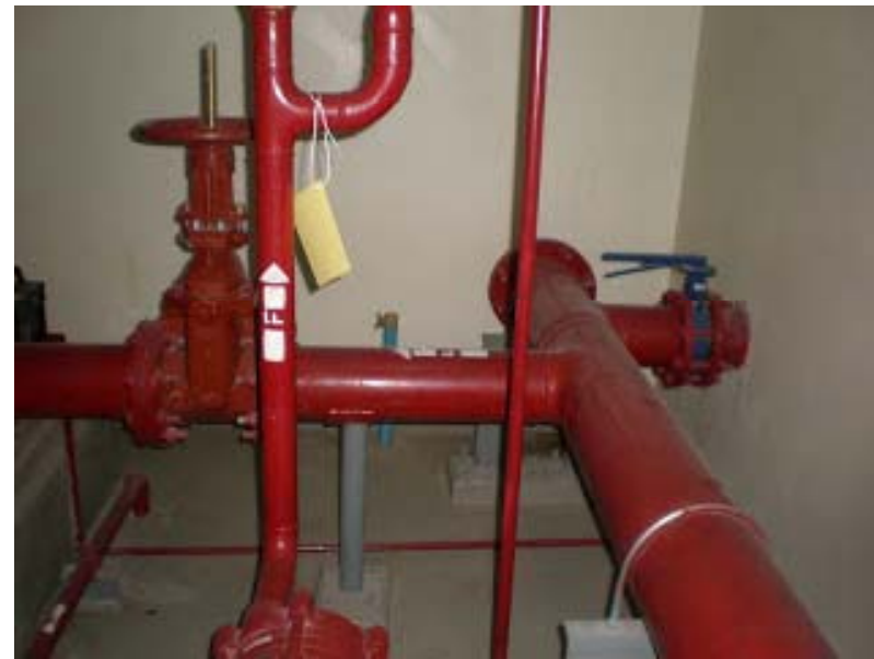
ระบบส่งน้ำดับเพลิง
